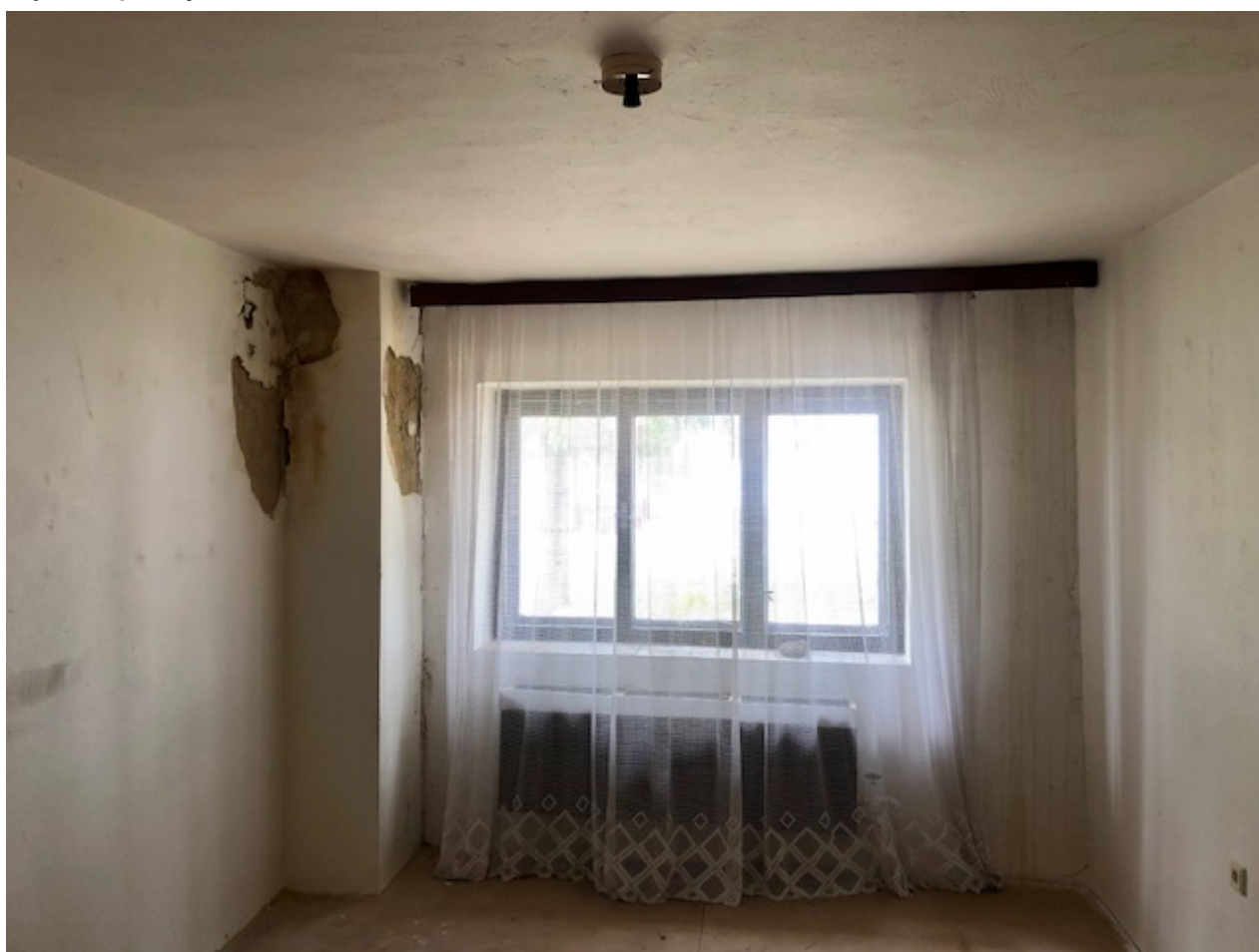
byt 1 – pokoj C – poškození stěn od zatékání střechou/stropem
