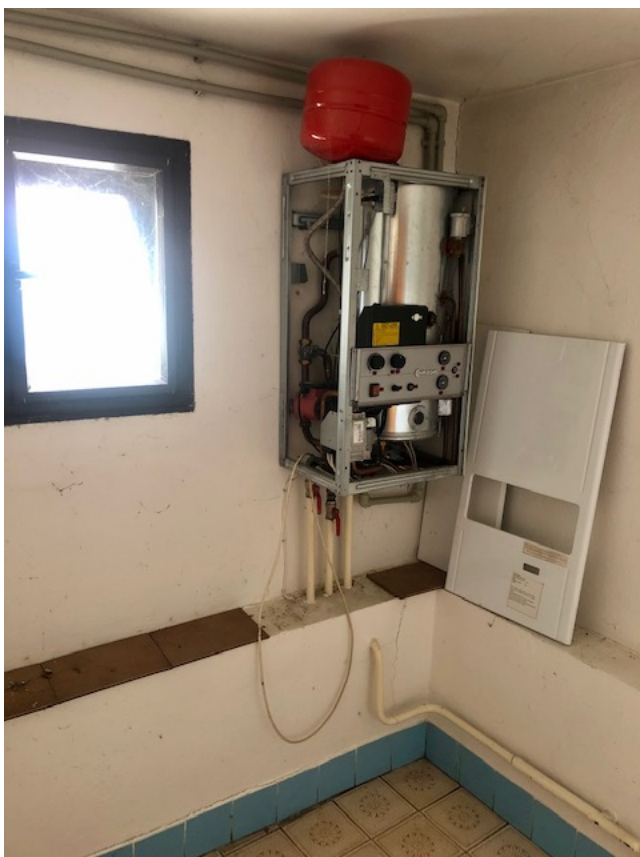
byt 1 – spíž s plynovým kotlem
