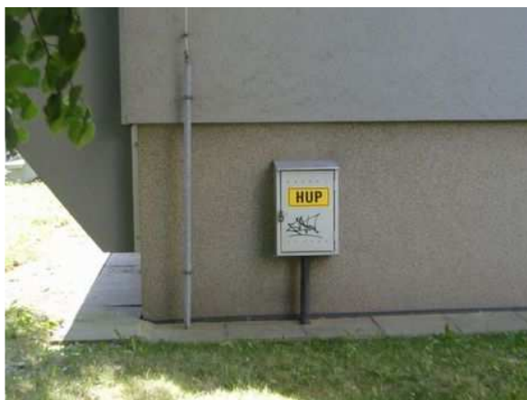
Nápojení domu na plyn
